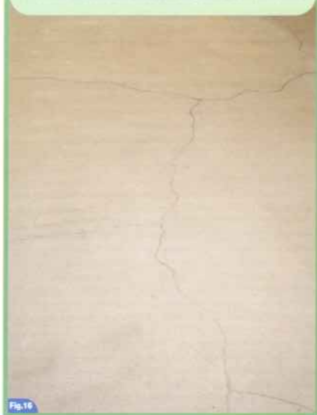
Presenza di fessurazioni sulla superficie del massetto
